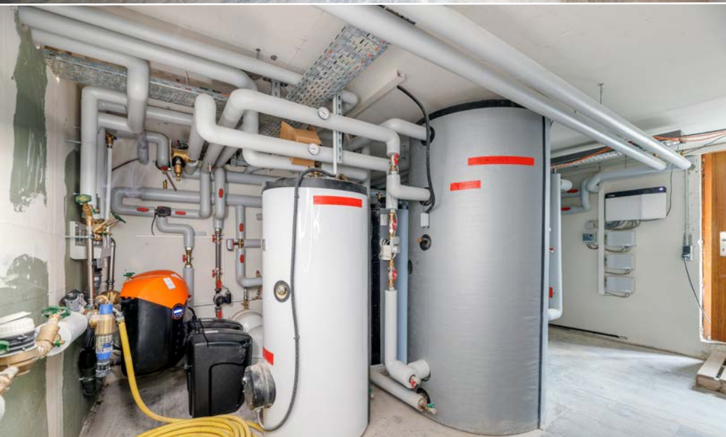
Zentrale Brauchwasserversorgung mit Vor- und Nachwärmstufe: In dem rechten Speicher wird das Wasser mit 55 °C vorgehalten und bei Bedarf in der Nachwärmstufe elektrisch auf 60 °C erhitzt.
