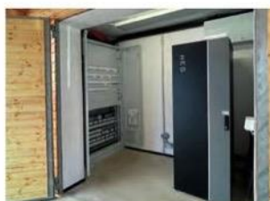
Bateriové úložiště HES. FENIX
