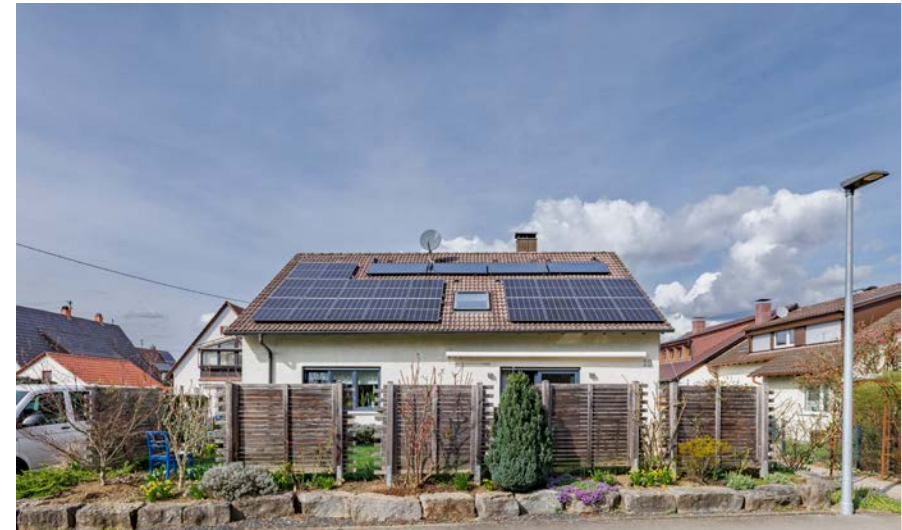
Die Dachfläche des Hauses bietet Platz für eine 8,1-kW-Peak-Photovoltaik- und eine Solarthermie-Anlage, die beide den Betrieb der Wärmepumpe unterstützen.
