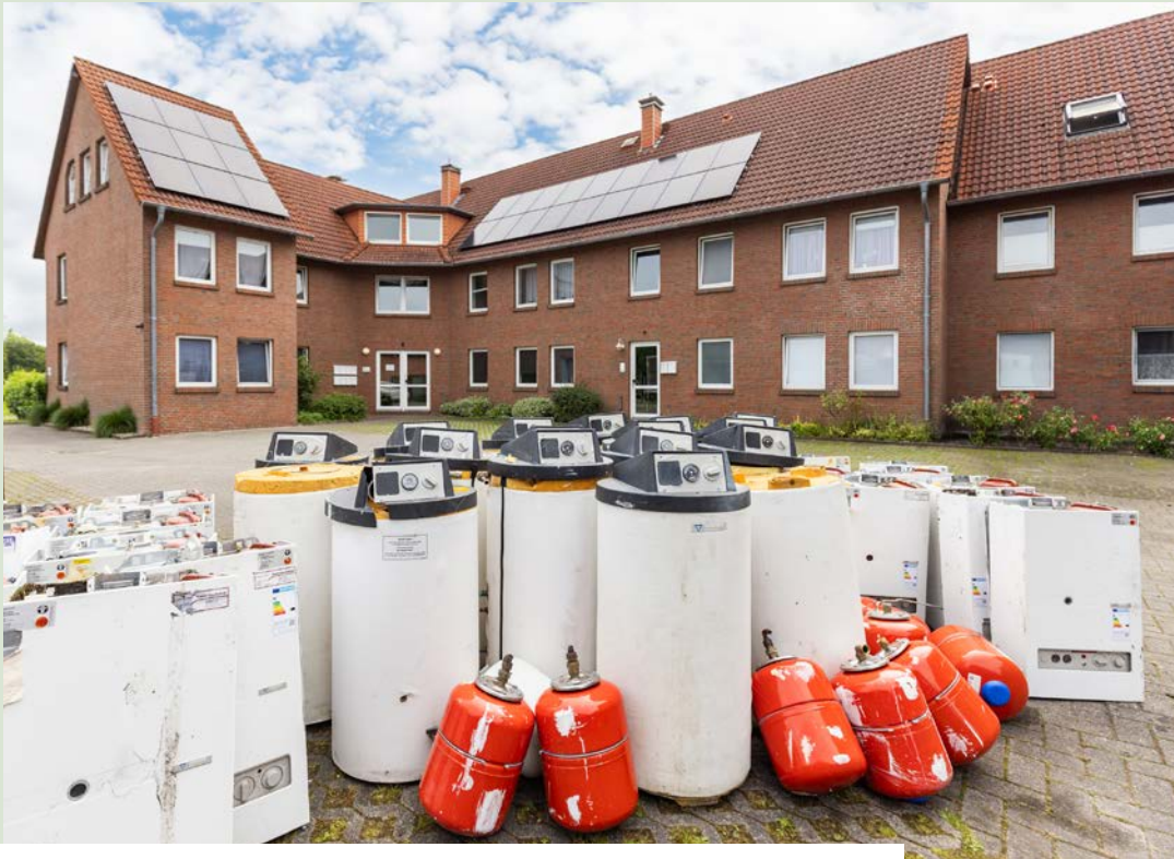
Ausgedient – die alten Gasthermen und Wasserspeicher sind reif für den Schrott.
