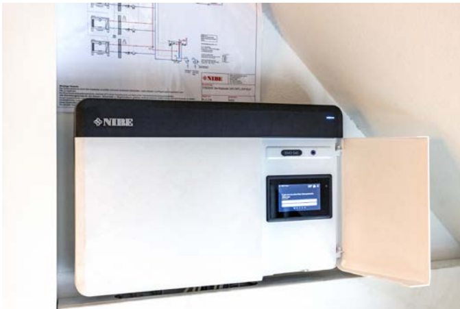
Das Regelgerät NIBE SMO S40 steuert den Betrieb der sechs Wärmepumpen.
