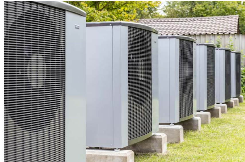
In Reih und Glied: 6 x 20 kW Heizleistung decken den Wärme- und Warmwasserbedarf von 20 Wohnungen.
