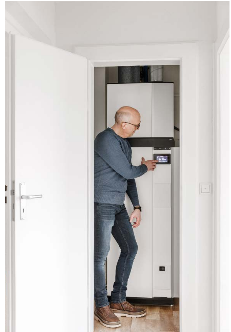
Begeistert: Frank Scholz erklärt die anwenderfreundliche Bedienung der kompakten Abluft-Wärmepumpe.
