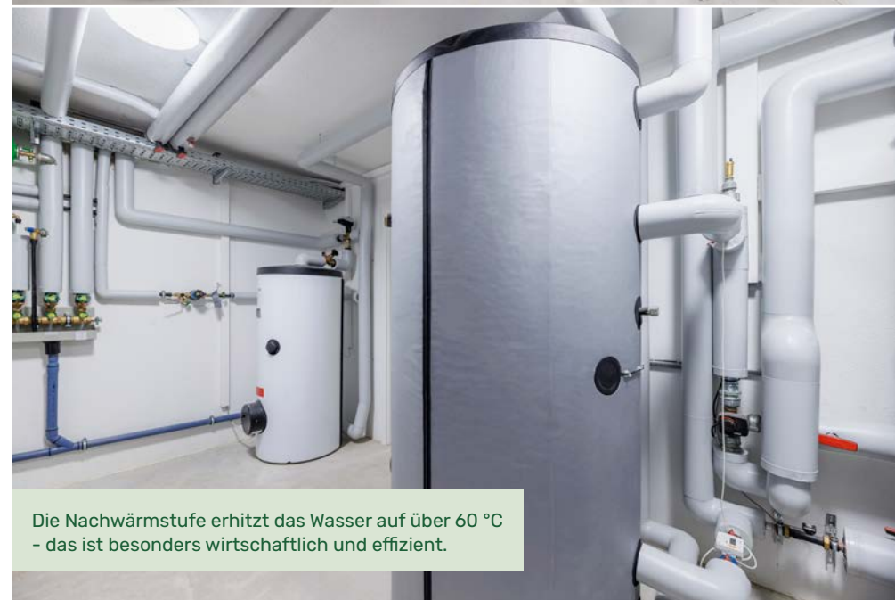
In dem großen Brauchwasserspeicher werden von der Wärmepumpe 900 Liter Wasser auf konstant 55 °C erwärmt und vorgehalten.
