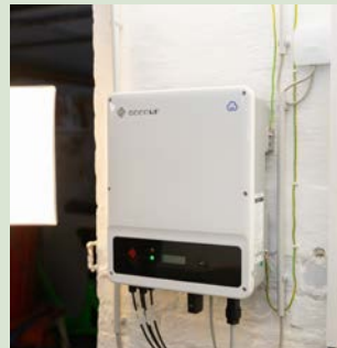
Der Goodwe-Wechselrichter kommuniziert mit der Wärmepumpe – so wird der PV-Strom optimal genutzt.
