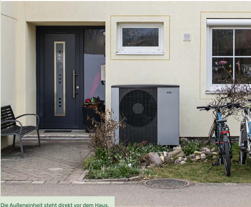
Die Außeneinheit steht direkt vor dem Haus.
