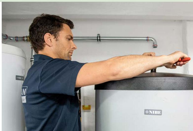
Während die Außen-einheit vor dem Haus montiert wird, sitzt bei Christian Schuschan im Heizungskeller jeder Handgriff.
