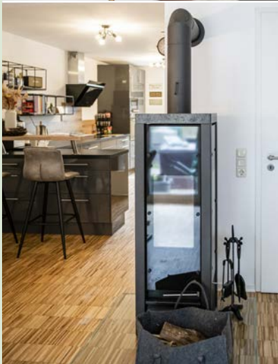
Der Holzofen im Wohnzimmer unterstützt die Wärmepumpe und sorgt für schnelle Wärme.
