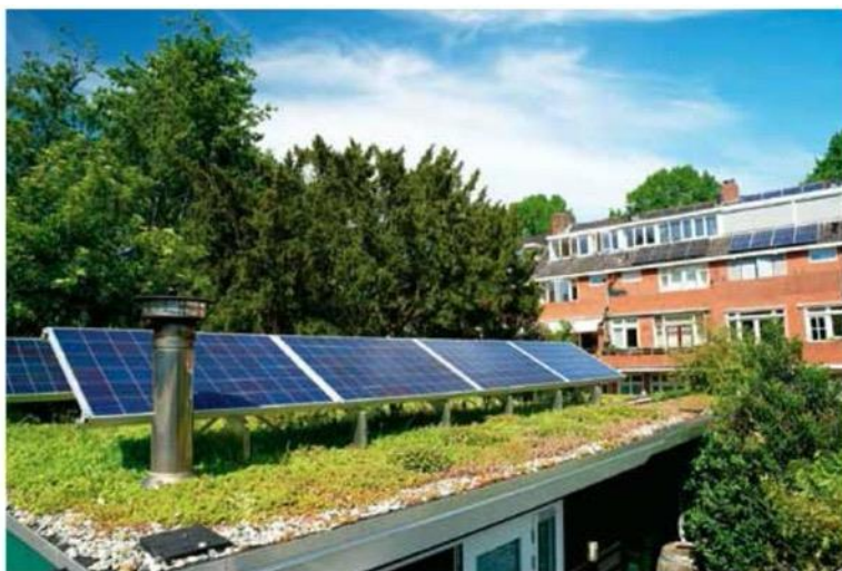
Vegetační střecha osazená fotovoltaikou
